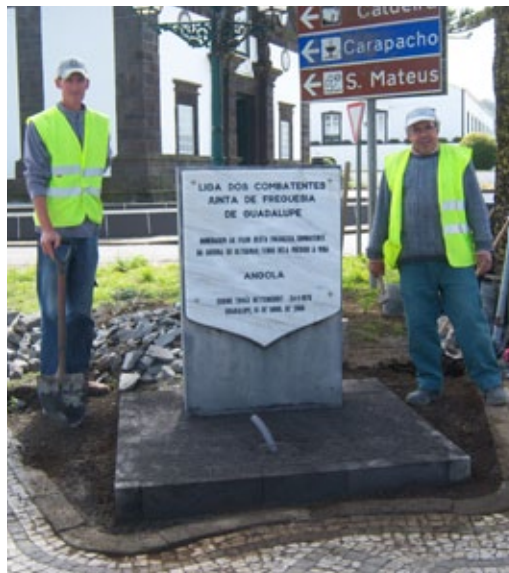
GUADALUPE - Recuperação de Monumento aos Combatentes já existente e colocação de iluminação.
